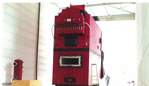
2 Chaudières bois de 3 MW
