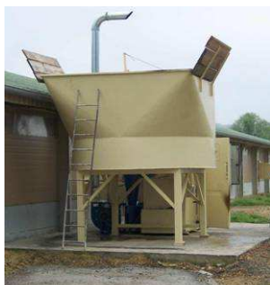
Générateur d'air chaud sur le bâtiment d'élevage (Source : Chambre d'Agriculture 52)
