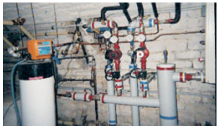
La sous-station de la maison Caillet
