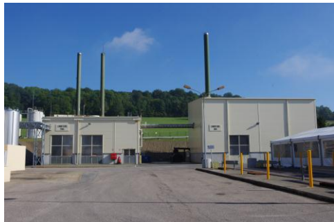
Installation Fioul et Biomasse
