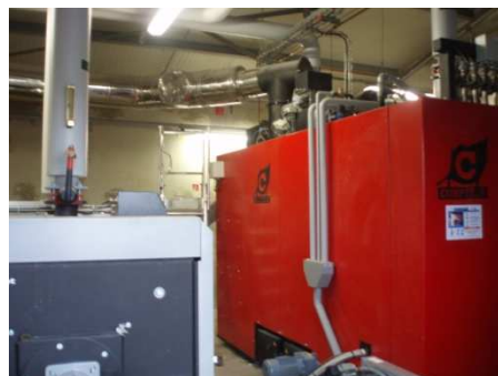
Chaudière bois (à droite) et gaz (à gauche)
