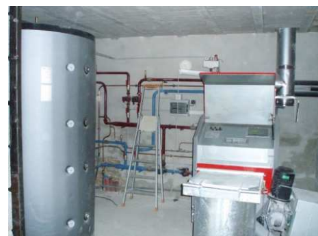
Chaudière bois (Crédit photo : Chambre d'agriculture de l'Aube)
